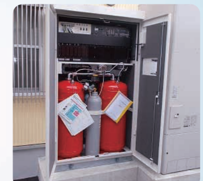
パッケージ型自動消火設備
