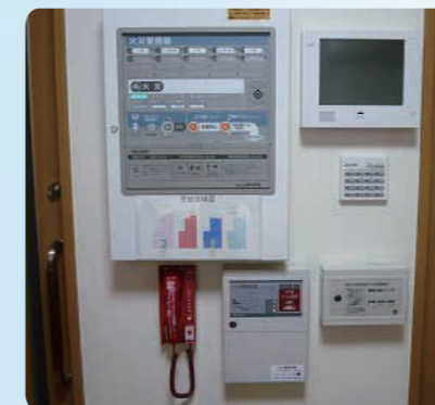
自動火災通報装置
